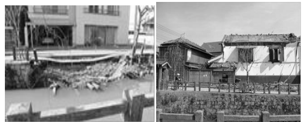
写真1 崩壊した護岸 (出典：香取市 HP)
